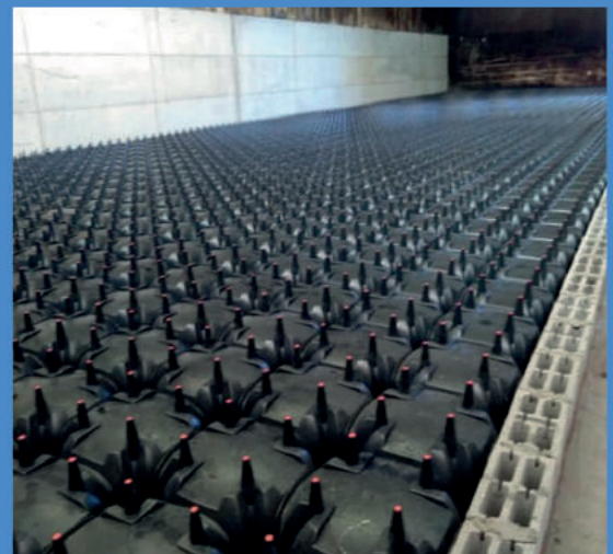
Fig.4 Esempio di installazione geoblocchi insufflazione biocella Example of geoblocks installation Biocell insuflation
