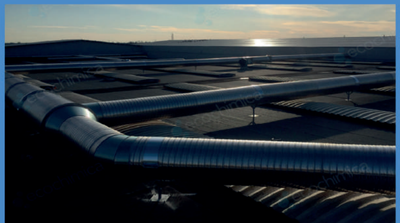
Fig.6 Sistema di canalizzazioni aerauliche di aspirazione della biocella a servizio impianto deodorizzazione Aeraulic ducting system for biocell suction for deodorization service
