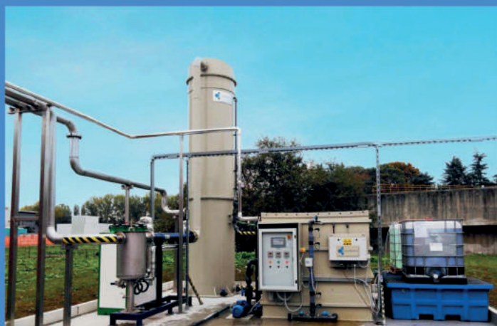
Fig.1- ECOCHIMICA DESOLF-R® installato in Lombardia ECOCHIMICA DESOLF-R® installed in lombardia
